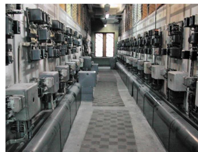
Lülite ja ajamite vahetuse ning releekaitse täiendamisega moderniseeriti enne maailmasõda ehitatud elektriamaade keskpingejaotlaid.
